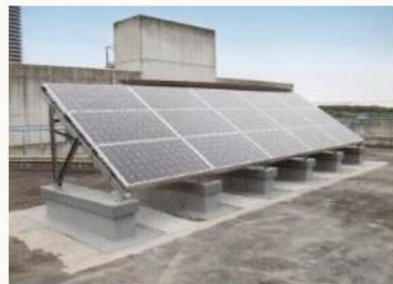
太陽光パネル
